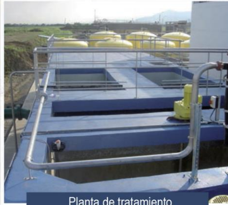
Planta de tratamiento de agua potable
